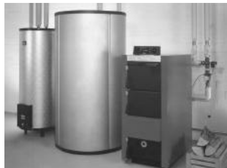
Stückholzgebläsekessel mit Puffer und Boiler
